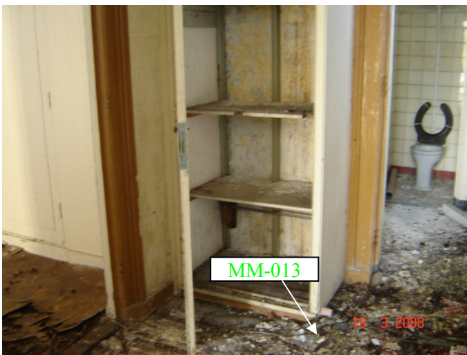
Foto 11 beplating deur (beschadigd)
